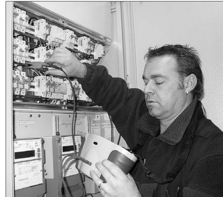
Willi Frischknecht kümmert sich um die Sicherheit rund um den Strom.
