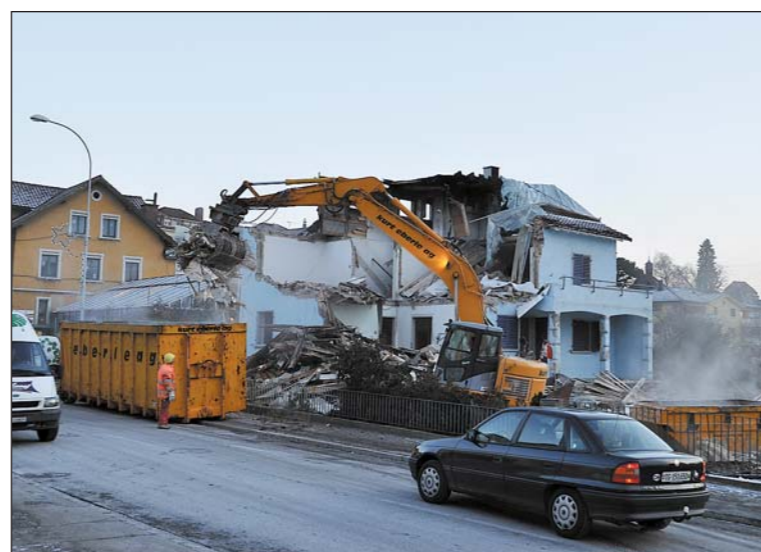
Am 17. Dezember beginnen die Abbrucharbeiten am blauen Haus an der Rebhaldenstrasse 10. Dies ist der Startschuss für die grösste je in Arbon realisierte private Bauinvestition: rund 60 Mio. Franken!
