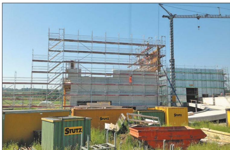
Die Holzwärmezentrale der EBM Wärme AG auf dem Gebiet der ARA Morgental soll noch in diesem Jahr in Betrieb genommen werden.
