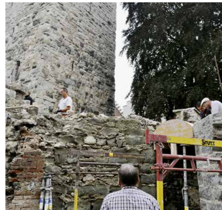
Interessante Baustelle in der Altstadt: Maurer sanieren Mauern, die aus unterschiedlichen Zeitepochen stammen.
