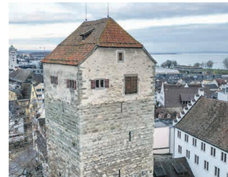
Der Arboner Stadtrat reagiert mit einer Medienmitteilung auf die jüngst geäußerte Kritik an der Schlossturm-Sanierung. Kevin Fitzi
